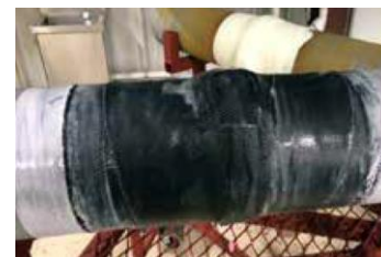
Krok 2: Zabezpieczenie systemu zamykania wycieków dedykowaną powłoką kompozytową DiamondWrap, by zapewnić długotrwałą bezawaryjną pracę systemu.
